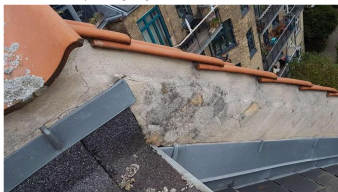
2: Brandkam med stor mængde af revnedannelser
