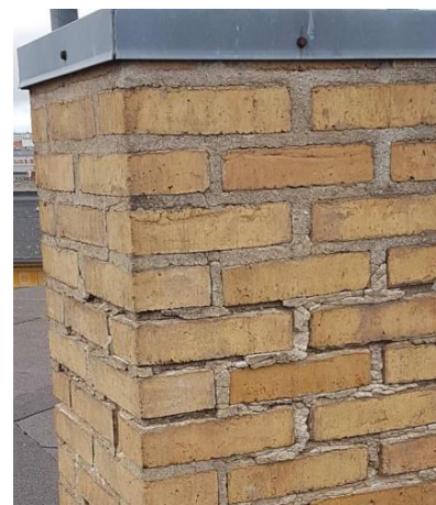
3: Skorsten med omfattende mangler af fuger
