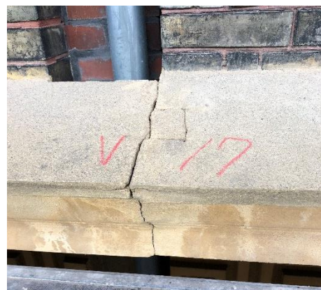
1: Gesims med revne
